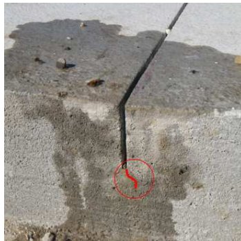
Figure 3. Fissuration observée au niveau des joints de sciage sur les dalles.
